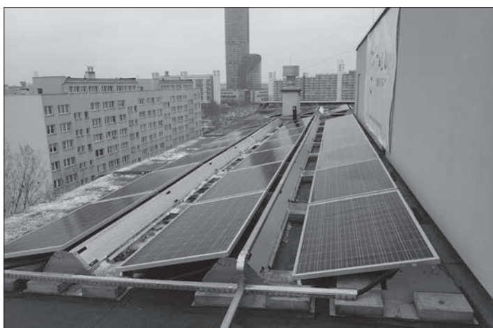
Fot. 1. Panele fotowoltaiczne na dachu budynku przy ul. Sanockiej 9, fot. Aureliusz Mikłaszewski
