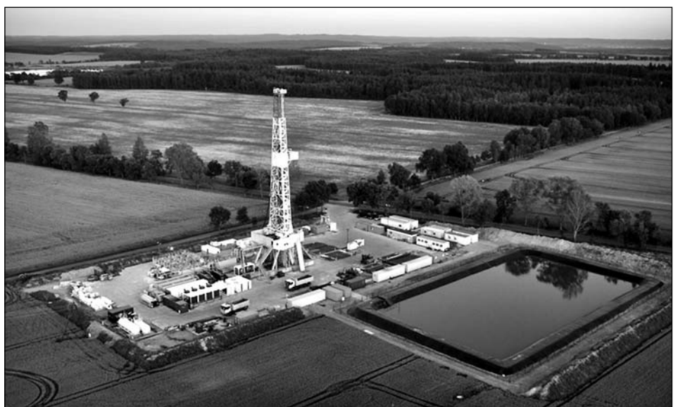
Ryc. 2. Tak wygląda platforma wiertnicza wraz z urządzeniami (wg W. Kielbika – referat na KK ds. OOS)
