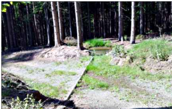
Fot. 8. Wodospust drewniany, jednobelkowy, pojedynczy, kierujący wodę z drogi leśnej wprost do dołu chłonnego/kałuży ekologicznej, to ochrona nawierzchni, ograniczanie spływu powierzchniowego i dodatkowa mikroretencja przy drodze leśnej w Nadleśnictwie Jugów. Fot. Ryszard Majewicz
