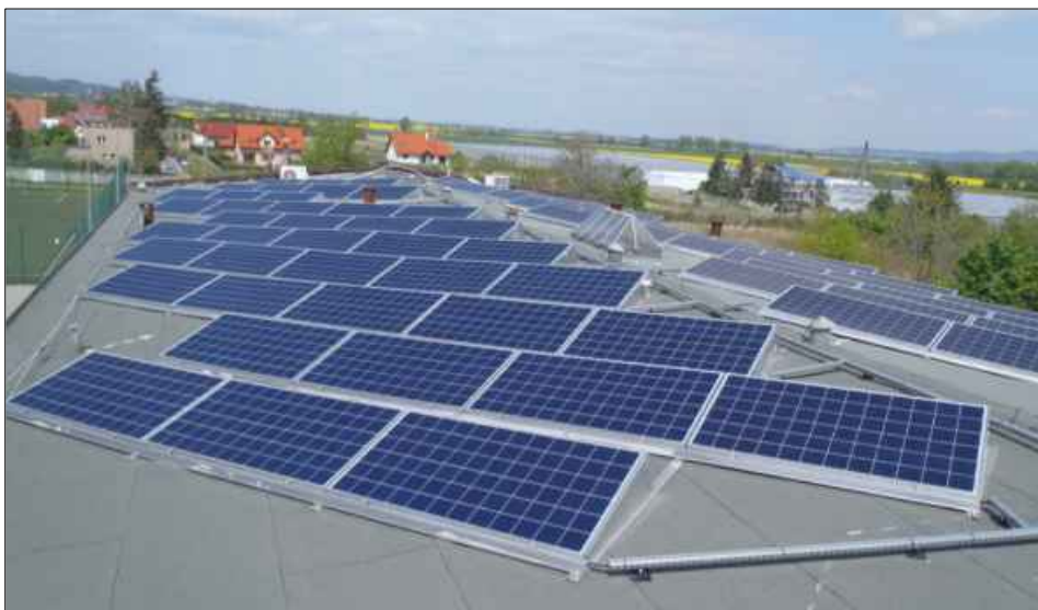
For. 2. Coraz więcej dachów pokrywają panele fotowoltaiczne. Fot. Aureliusz Mikłaszewski
